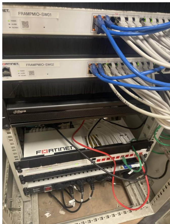
Photo 3 – FortiSwitch SW01, SW02, NVR Dahua et FortiGate FW01 dans la baie
