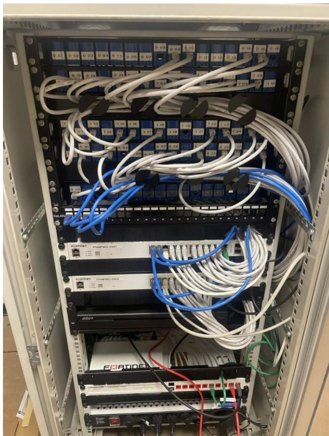
Photo 1 – Vue générale de la baie de brassage principale
